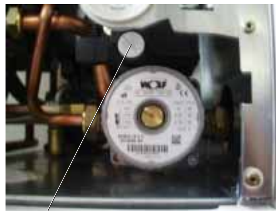
Wahlschalter für Pumpenstufe
