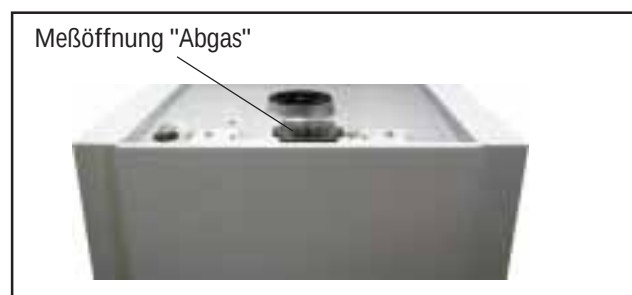
Bild: Abgasmessung bei geschlossenem Gerät
