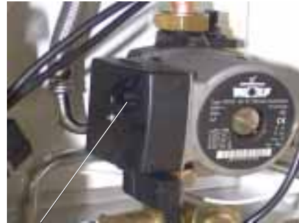
Wahlschalter für Pumpenstufe
